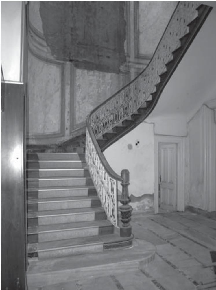
Abb. 4 Blick in das Haupttreppenhaus mit dem Lauf aus Nußholz und den Resten der originalen Wanddekoration im Zustand 2012
