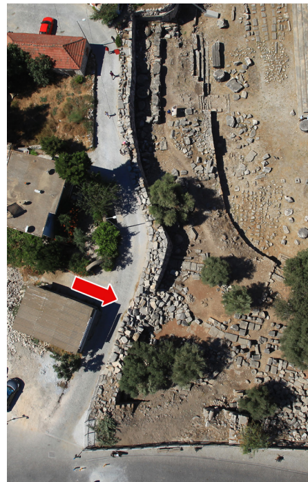
12 Tempelareal, ‚Mandramauer‘ (Südost-Ecke), Luftbild 2015 mit dem eingestürzten Abschnitt 6 (roter Pfeil) vor Wiederaufbau. (Foto: E. Küçük)
