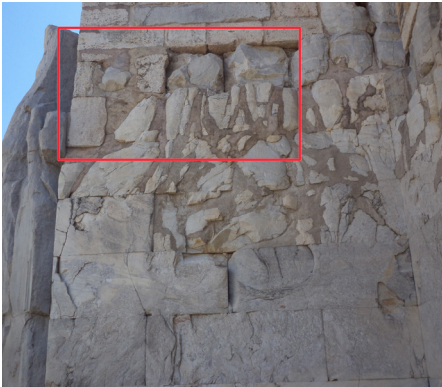
22 Apollontempel, Zweisäulensaal, Ostwand, südl. Abschnitt, Zustand vor der Sanierung 2017. (Foto: Ch. Kronewirth)
