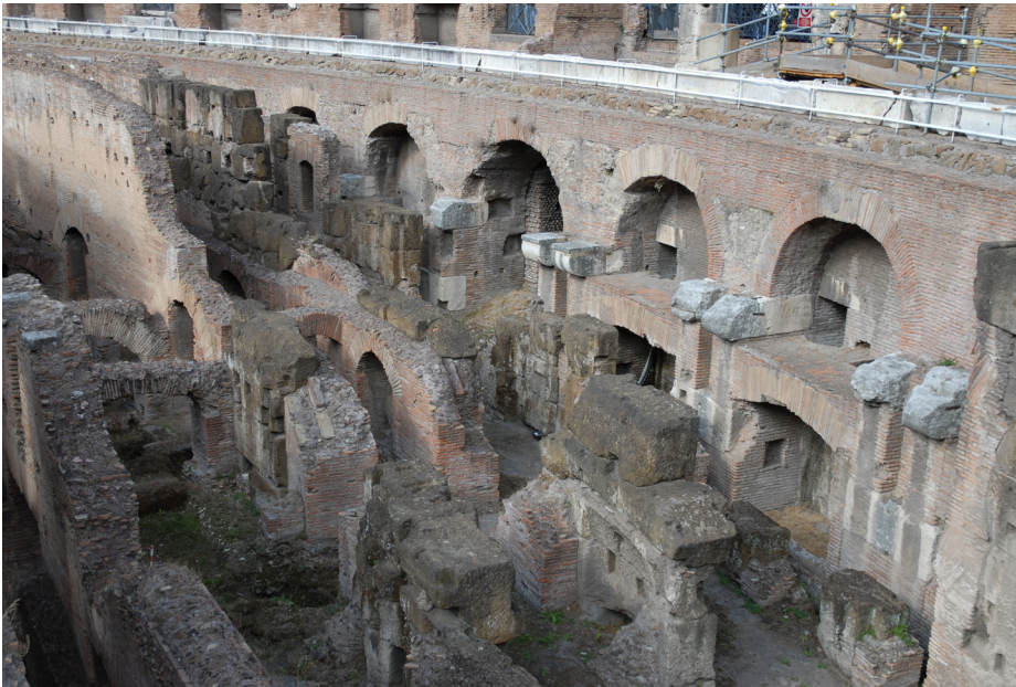
2 Umfassungsmauer mit der Nische 8, 9, der Galerie 36 und der Nische 10. (Foto: H.-J. Beste)
