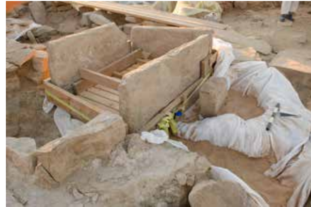
20 Tayma (Saudi-Arabien). Becken aus mehreren Sandsteinplatten im Zentrum eines nabatäischen Tempels (Gebäude E-b1) während der Durchführung von Sicherungsarbeiten im Rahmen der Konservierung (Foto: J. Jurgasch, DAI Orient-Abteilung).
