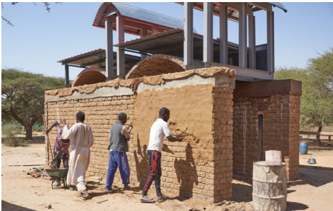
13 Meroe Royal Baths, Testbau im Rahmen der Schutzbau-Planung: Fertig gestellte zweischalige Dachabdeckung auf dem gegossenen Ringbalken. Ausführung einer weiteren Musterfassade mit gelblichem Kalkverputz auf dem Lehmziegelmauerwerk. (Foto: H.-U. Onasch/DAI, D-DAI-Z-MRB_20200304_DG-8903_HU)
