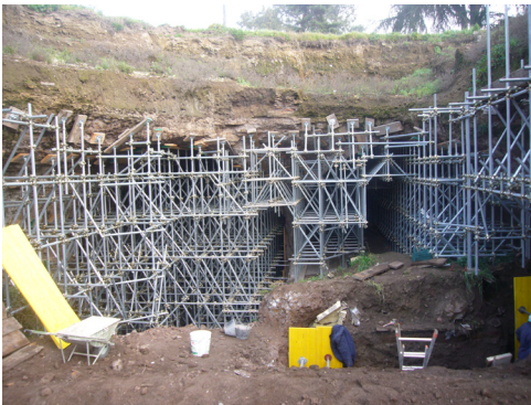
29 Rom, Domus Aurea : eingebrochene Magazin-gewölbe. (Foto: H.-J. Beste)
