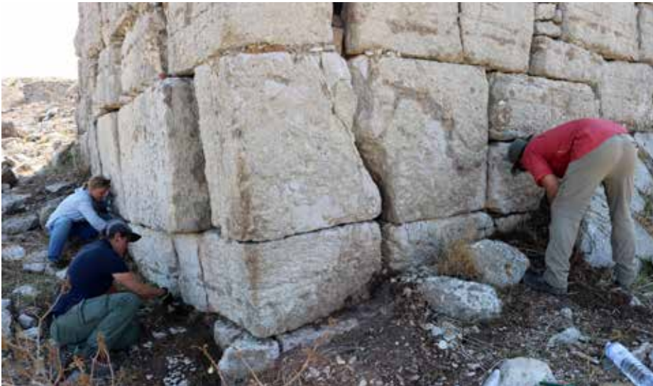
13 Oberflächliche Reinigungsarbeiten an der Ecke des Nordturms. Deutlich sichtbar sind die Risse und Verformungen im Mauerwerk (Foto: C. Winterstein).
