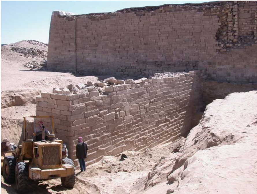
Abb. 8. Jemen: Nordbau des Großen Dammes von Marib. Die Bühne K während der Freilegung. Die Tosbeckenmauer im Hintergrund steht an dieser Stelle etwa 16 m hoch an.
