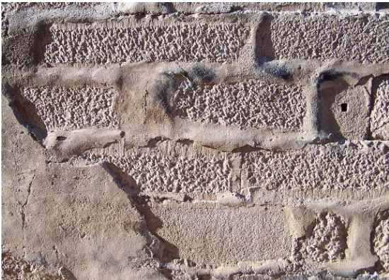
Abb. 23. Marib, Nordbau des Großen Dammes, Auslassbereich. Die Fugen sind mit Qadbat vergütet, das Mauerwerk (wie auch die Auslasssohle) zusätzlich verputzt.
