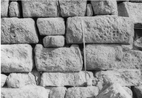
Abb. 5 Pyrgos Plakas, Nordwand mit Zwischenschicht, 1999
