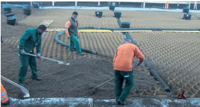
Abb. 33 c Domus Aurea, die wichtigsten Schritte in der Umsetzung des SIP. Verlegung des wasserführenden Materials (Tonkugeln) vor der Umsetzung des Gartens darüber. Man sieht deutlich die schwarzen Hohlkörper des Systems ›Arianna‹, in welche die Elemente zur Kontrolle des Wasserflusses und die Apparate zur Steuerung des Wärme- und Feuchtigkeitsaustausches eingelassen sind
