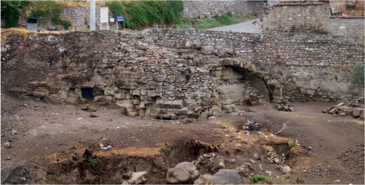
Abb. 40 Pergamon, vorstädtischer Bereich. Kazancı Köprüsü, Ansicht des östlichen Landpfeilers nach den Reinigungsarbeiten 2013 von Nordwesten
