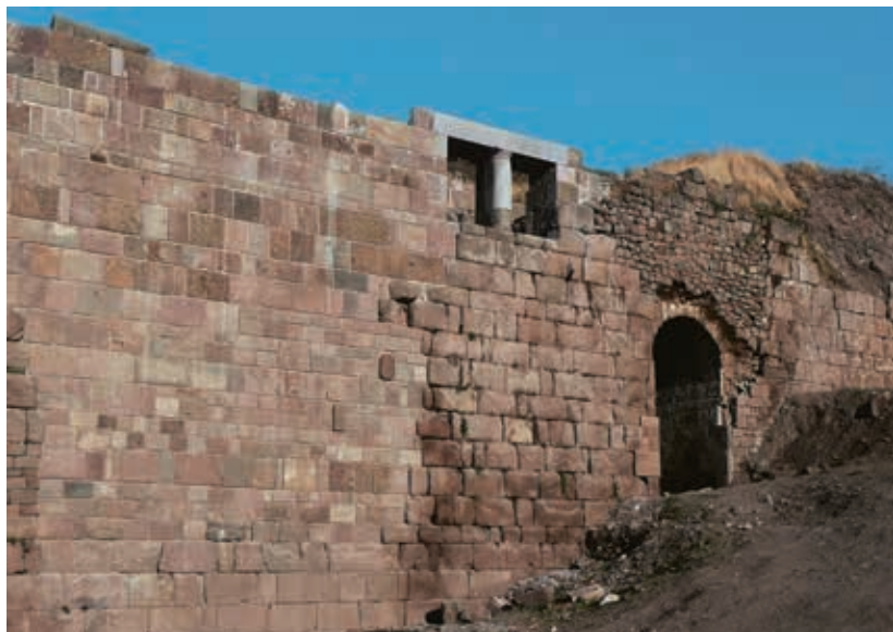
Abb. 78 Pergamon, Gymnasion. Das wiederhergestellte gekuppelte Fenster in der Osttreppe und die Füllung in der Mauerbresche nach Abschluss der Arbeiten 2013
