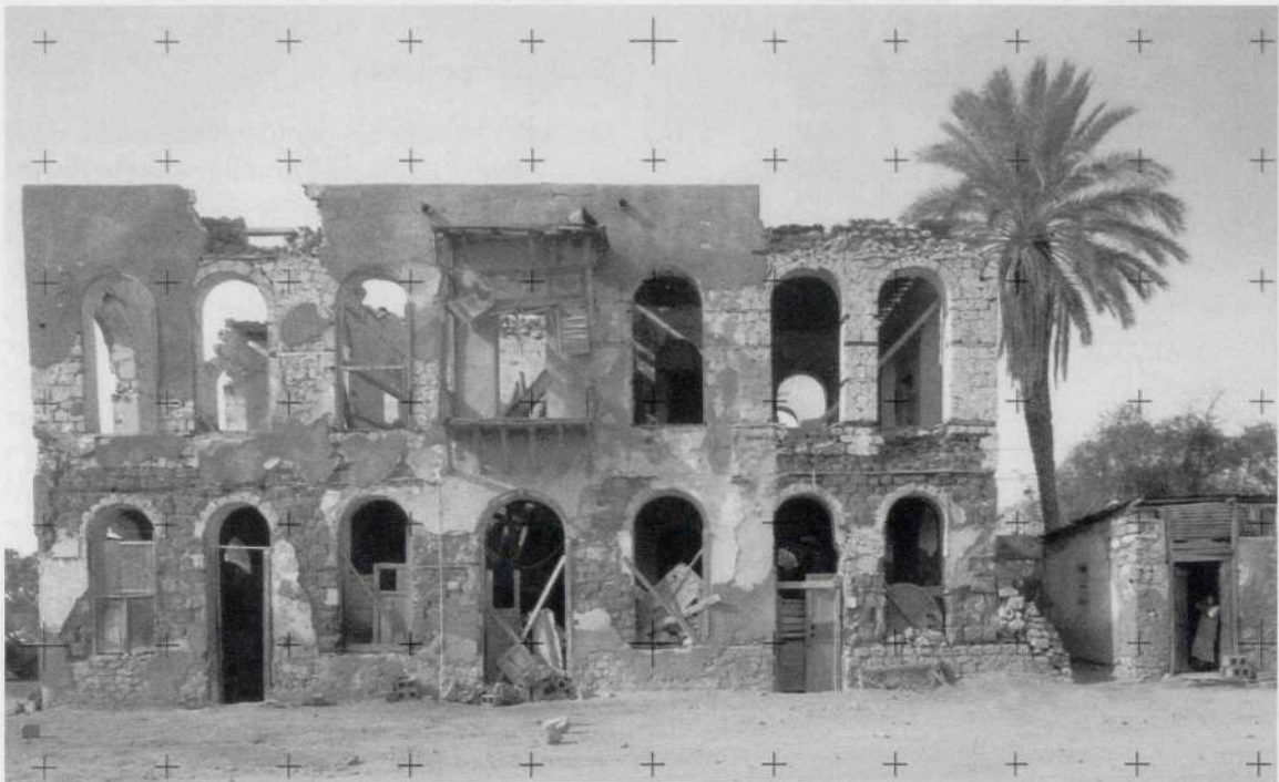
Abb. 11. Massawa: Messbild eines stark beschädigten Eckhauses (Block 139).
